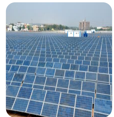
10 MW Land solar
